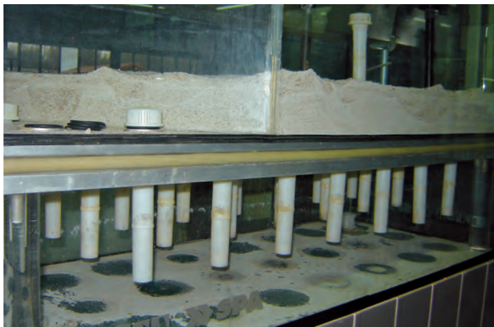
Figura 11 - Lavado de filtros de arena en la ETAP de Burgos.
