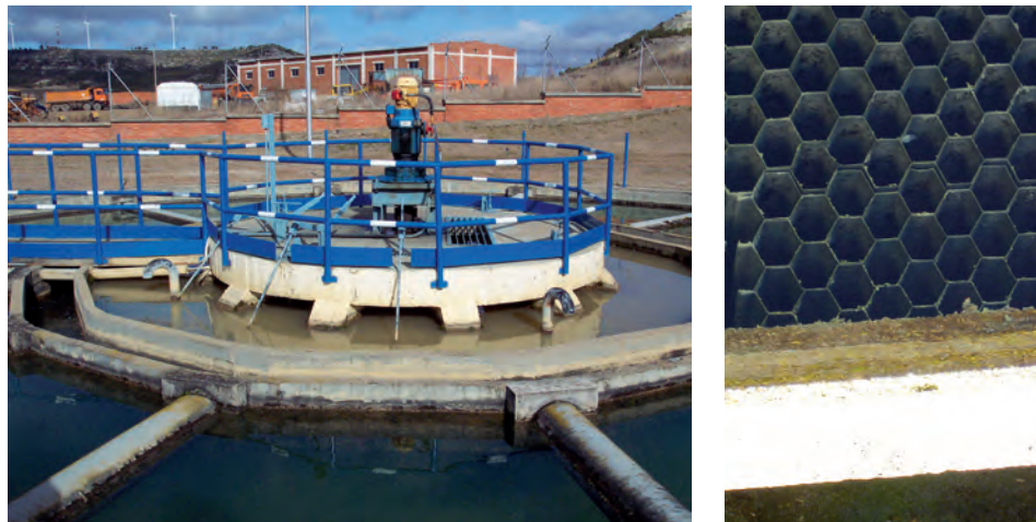
Figura 8 – Decantador de la ETAP de Palencia (izquierda). Decantadores hexagonales. ETAP Zamora (derecha).
