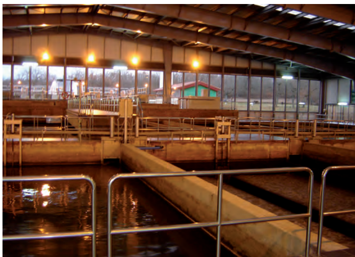
Figura 2 - Instalaciones de la ETAP de Burgos.
