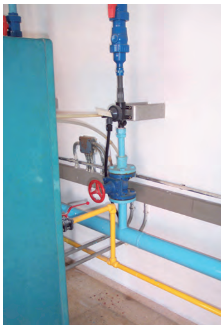
Figura 21- Dosificador de cloro gas. ETAP Palencia.
