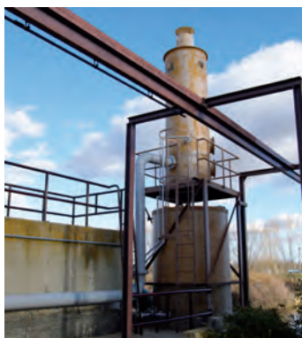
Figura 27 - Neutralizador de cloro. ETAP de Salamanca.
