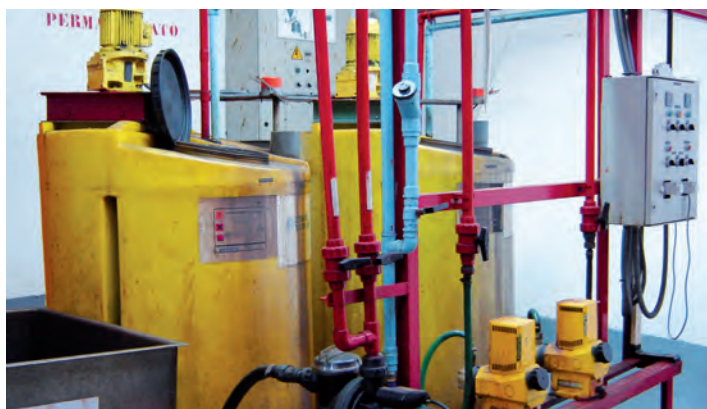
Figura 32 - Dosificación de permanganato potásico. ETAP de Zamora.
