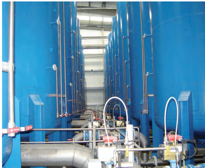
Figura 12 - Filtros de carbón activo. ETAP Ávila.
