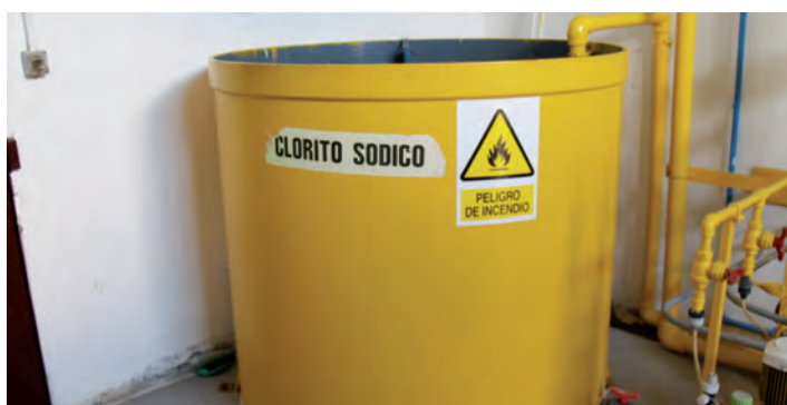
Figura 28 – Tanque de clorito sódico para la obtención de dióxido de cloro.
