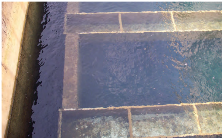
Figura 13. Detalle del filtro de carbón activo de la ETAP de Palencia.
