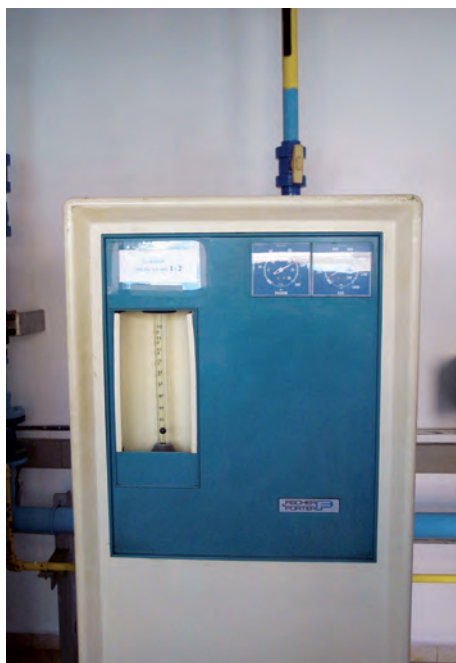
Figura 20 - Dosificador de cloro a vacío. ETAP Palencia.
