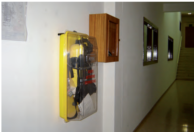
Figura 26 - Equipo de protección. ETAP Zamora.
