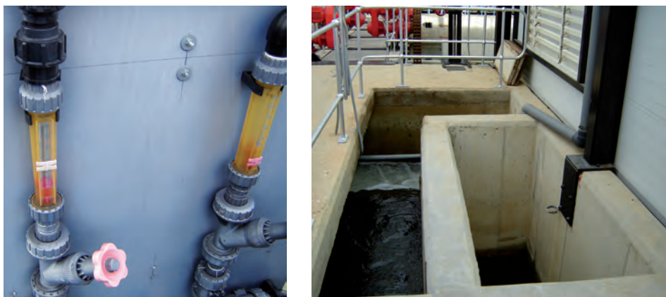
Figura 6 - Dosificador del floculante de la ETAP de Ávila (izquierda) y cámara de mezcla de la ETAP de León (derecha).
