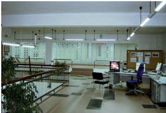
Figura 25 - Sala de control de la ETAP de Burgos.
